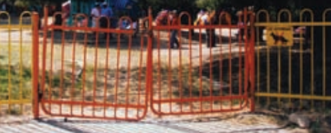
Εικ. 11: Σπασμένη ανάρτηση πόρτας λόγω μη απαραίτητης βαριάς κατασκευής της
